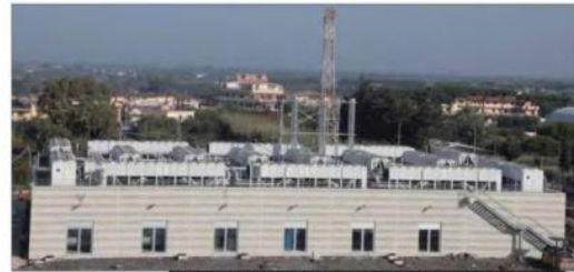
Centrale tecnologica (Veduta d'insieme) - Technological Plant (View)
