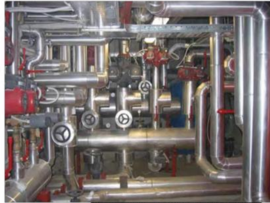
Sottocentrale termofrigorifera zona "cementi" - Special Plant
