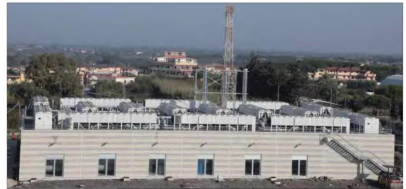
Centrale tecnologica (Veduta d'insieme) - Technological Plant (View)
