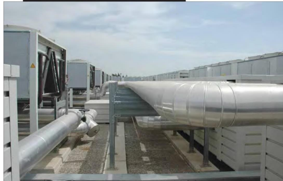
Particolare della centrale tecnologica - Technological Plant (Detail)
